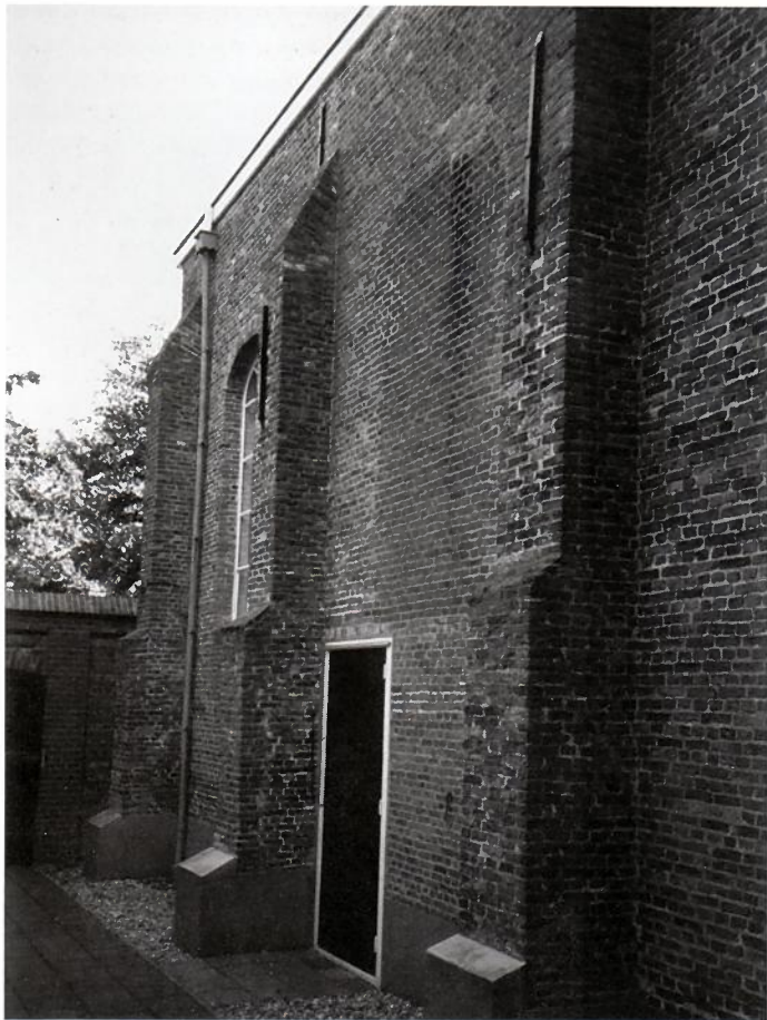
Westgevel van de kerk waarin duidelijk waarneembaar is dat hierin nog een raam heeft gezeten. (foto: H. H. Vogel).
